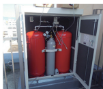
スプリンクラー設置後
